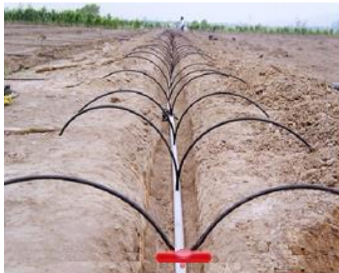
Figura 91. Tubería portalateral y laterales.
